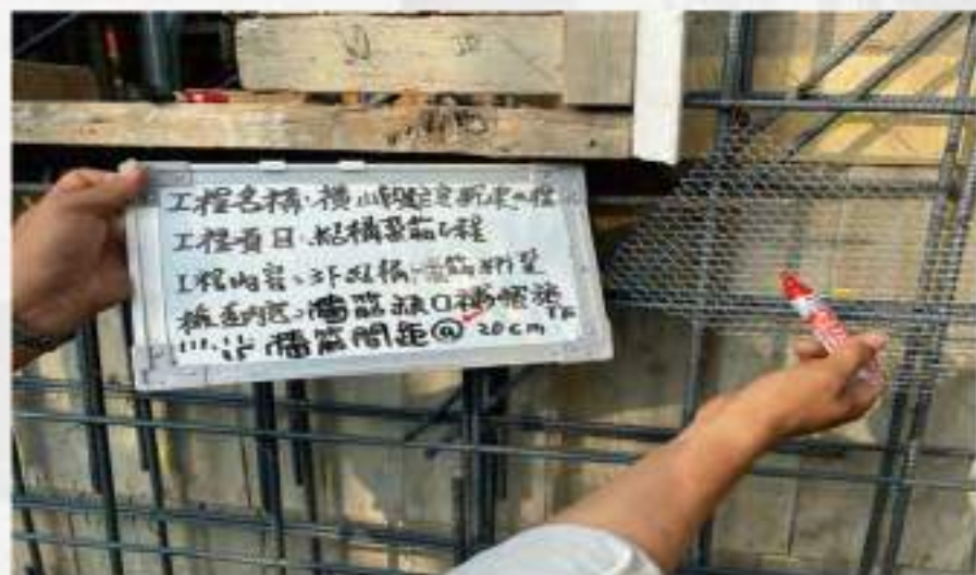
預留窗戶開口結構鋼筋 45度角補強及抗裂網 綁紮避免截角裂縫產生 施作
